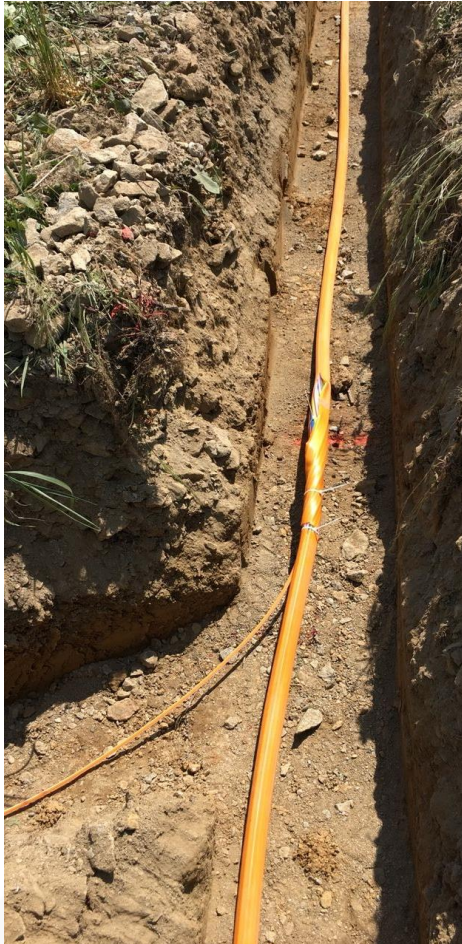
Kabelverbund in Trasse mit Hausabzweiger
